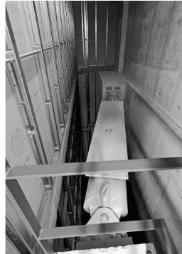
制振装置：オイルダンパー (撮影：株式会社エスエス大阪)
